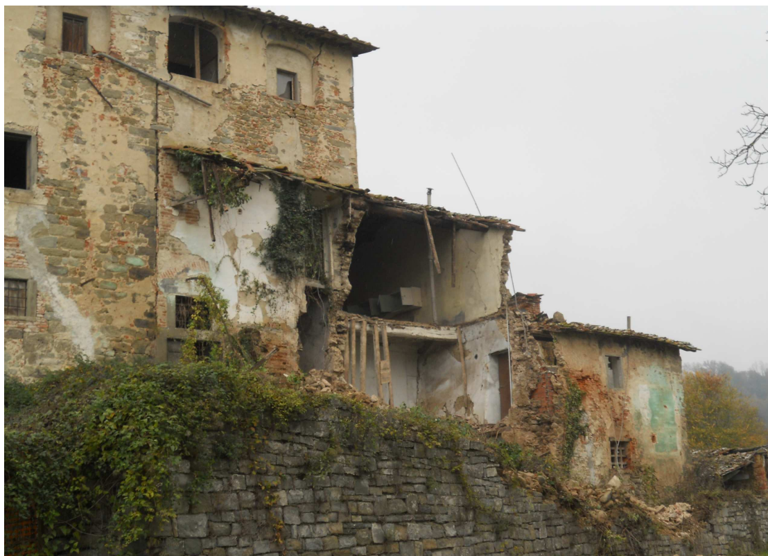
Crollo strutturale avvenuto nel Dicembre 2012
