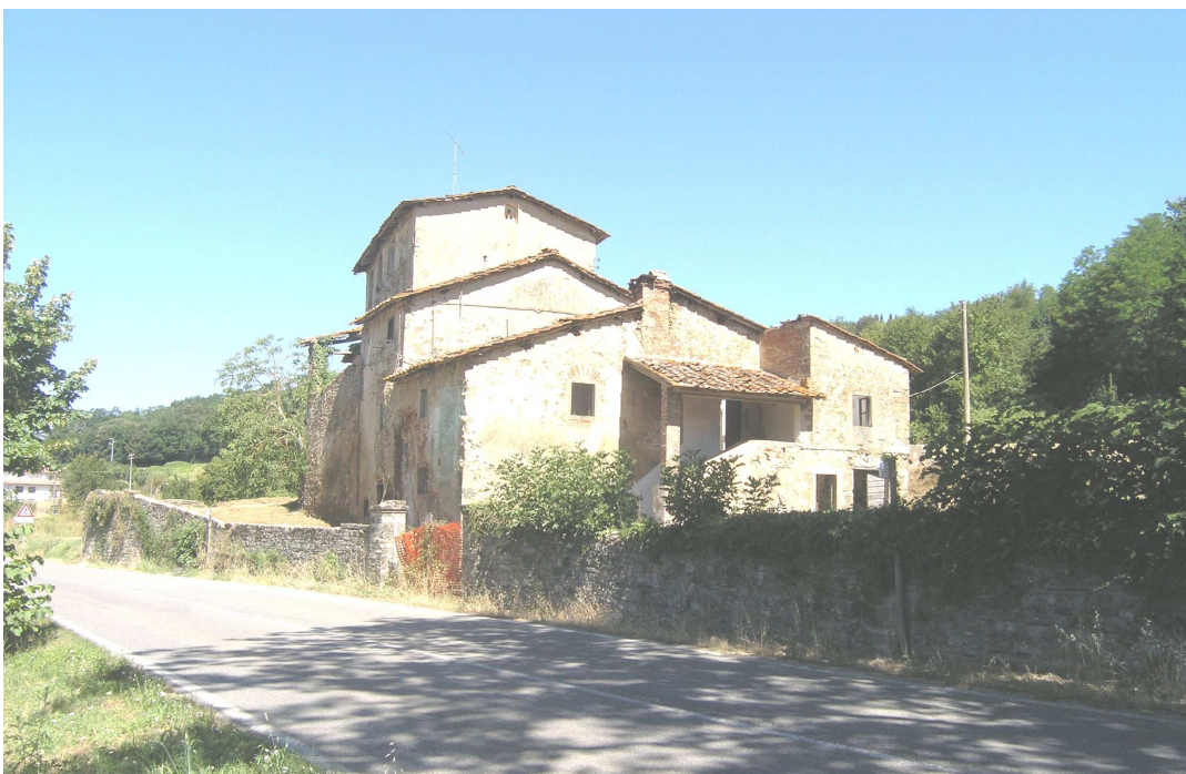
Stato antecedente i crolli strutturali
